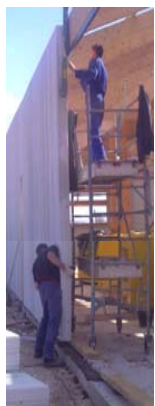
Pose de bardage en béton cellulaire (site de régénération de fibres optiques, plus de 30 sites en France). Maître d'Ouvrage LD Com Conception et réalisation Sogea Nord Ouest
