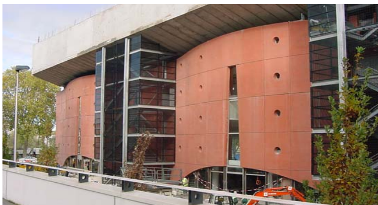
Chantier du multiplexe cinématographique Gaumont à Angers. Maître d'Ouvrage GAUMONT; Architectes : DARONIAN - GAYET- VEDRES BALTRUSAITIS.
